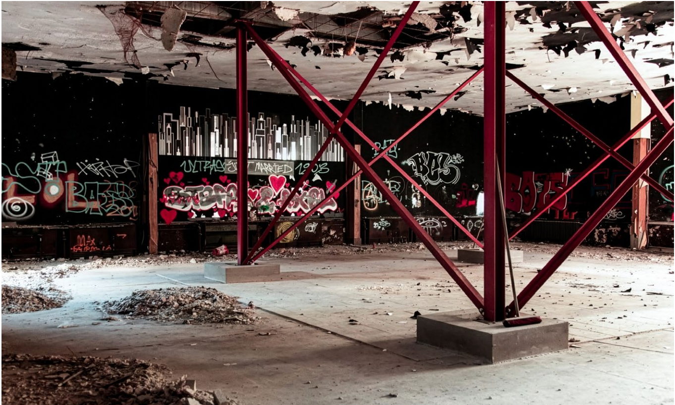
Abb. 2: Großer Saal, Zustand 2022. Korrosionsschäden an den Ankerpunkten der Dachkonstruktion machten den Einbau einer Stützkonstruktion notwendig. (Foto: Michaela Maier)
