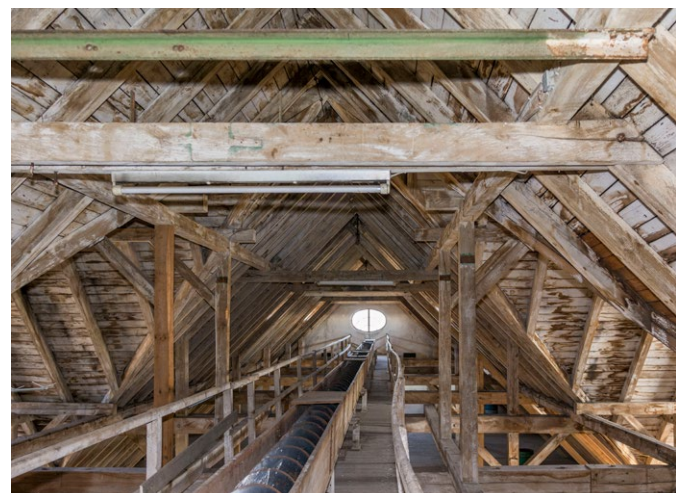
Abb. 2: Dachstuhl mit Transportschnecke vor der Sanierung (Foto: Jacob Bestgen)
