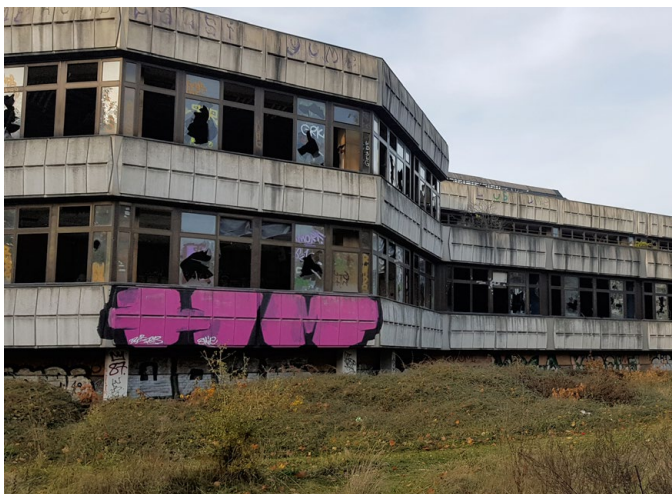
Abb. 3: Problem Asbestsanierung (Foto: Jost)
