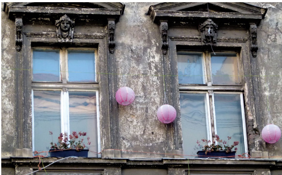
Abb. 2: Auch Fensterkitt mit Einbaudatum vor 1993 ist häufig asbesthaltig (Foto: Jost)
