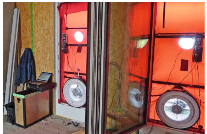
Abb. 3: Hausprojekt Boyenstraße in Berlin-Mitte, Lüftungsanlage
