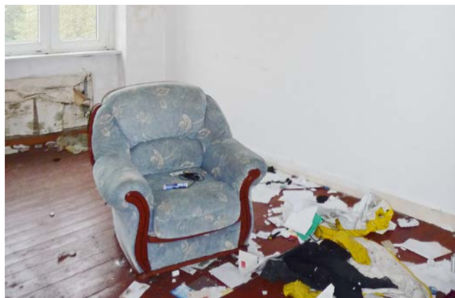
Abb. 1: Eines der Problemhäuser in der Dortmunder Nordstadt im Oktober 2012. Zu diesem Zeitpunkt stand das Gebäude offiziell leer, augenscheinlich wurde es jedoch zeitweise bewohnt. (Foto: Katharina Pelka)
