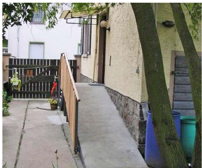
Abb. 2: Nachbesserung für behindertengerechten Zugang (Foto: Thomas Wolf © Wüstenrot Stiftung)
