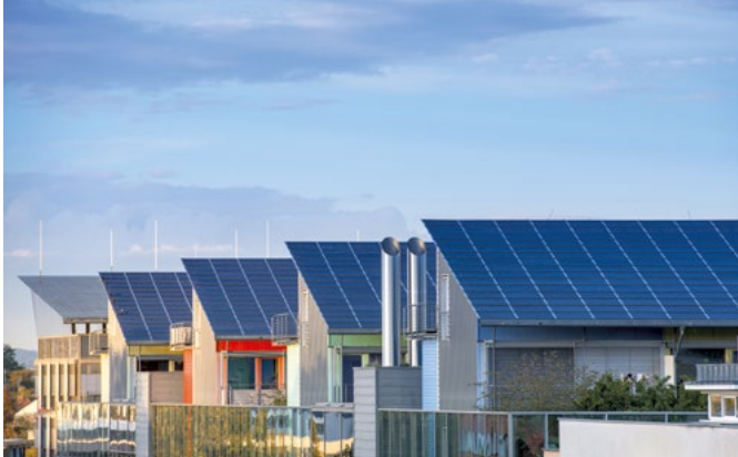
Abb. 2: Photovoltaik-Anlage auf dem Gebäudedach (Foto: Fotolia)
